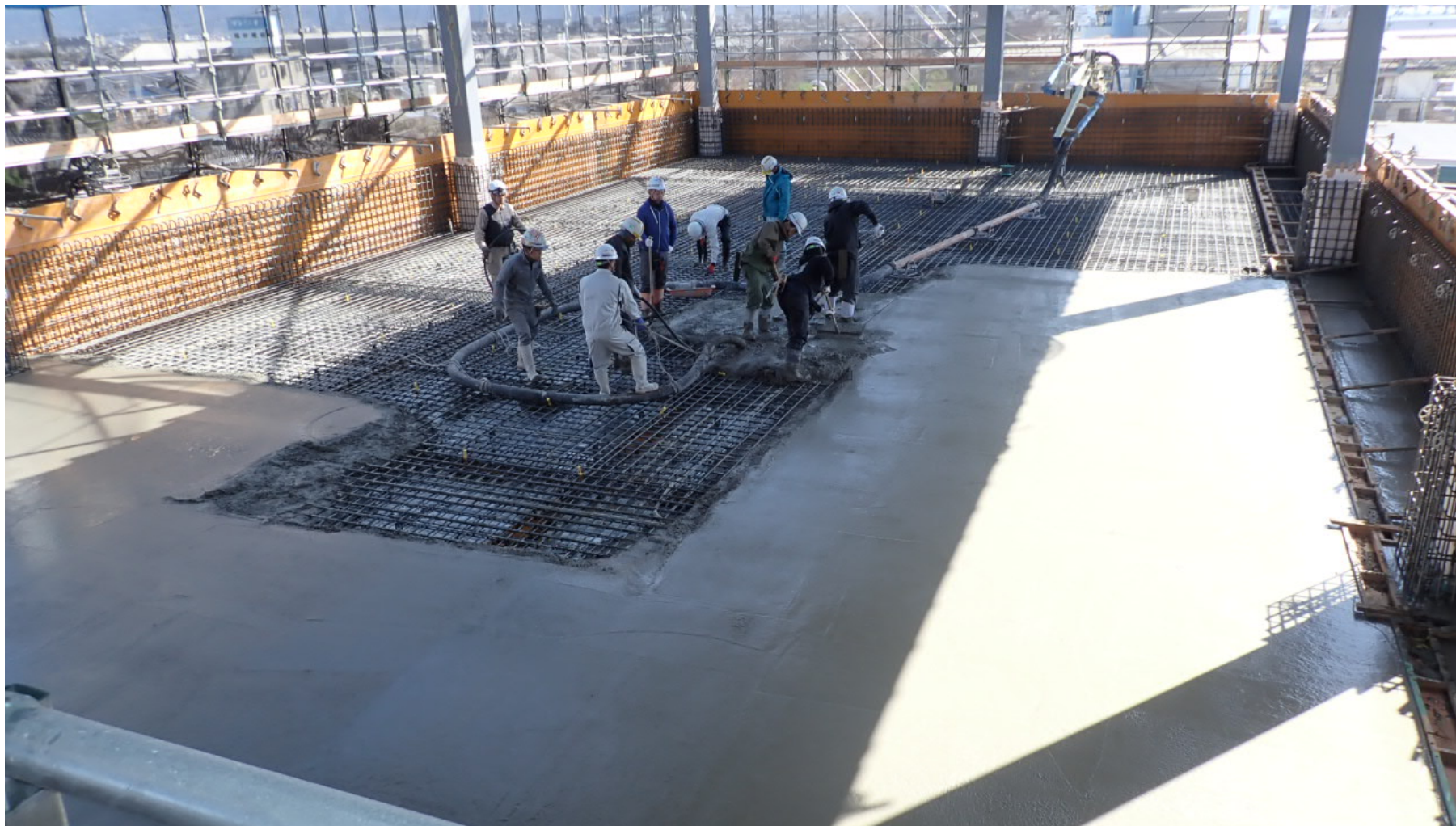
工事状況写真 (2F スラブコンクリート打設工事 2階建て駐車場)
