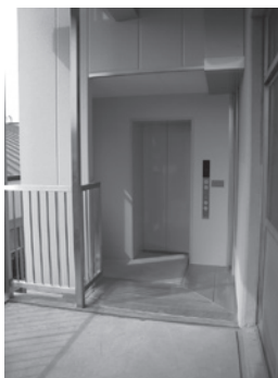
菅原小学校エレベーター
