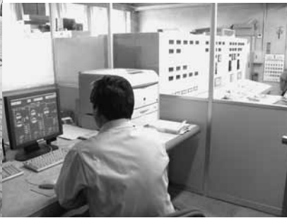
各配水場の遠隔監視をおこなう中央監視室
