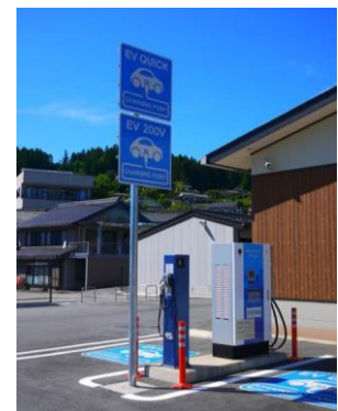
【充電設備の設置例】
