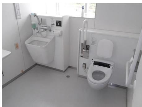
【オストメイト対応多目的トイレ】
