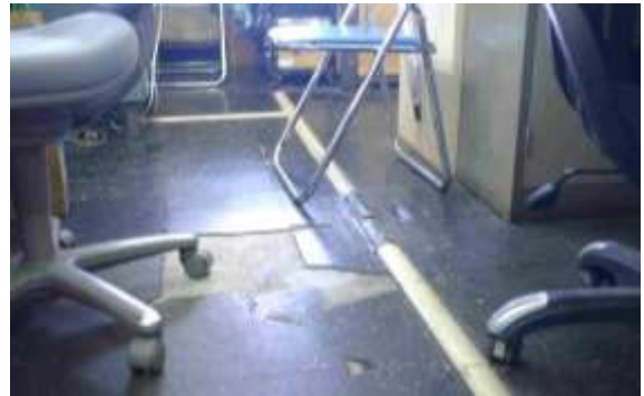
【執務室の床上配線】
