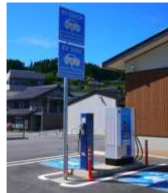
【充電設備の設置例 (設楽町庁舎)】
