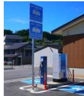
【充電設備の設置例 (設楽町庁舎)】
