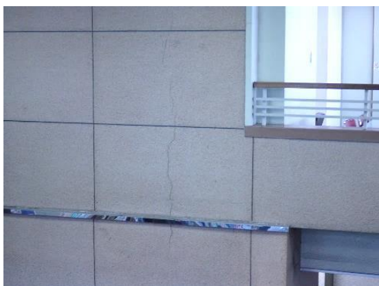
【クラック(ひび割れ)が発生している様子】
