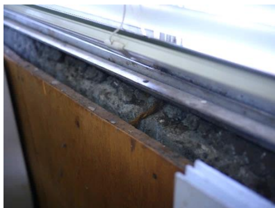
【劣化したコンクリートがむき出しになっている壁】
