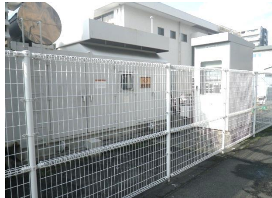
【屋外地上に設置された非常用発電機】
