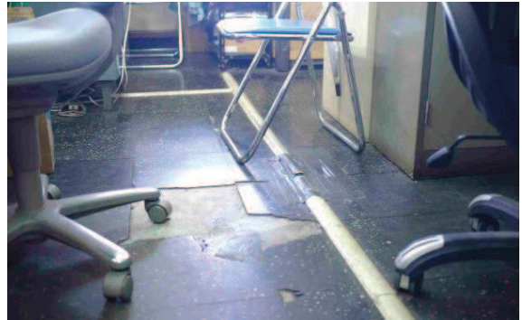
【執務室の床上配線】
