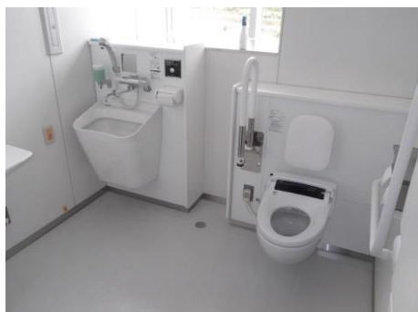
【オストメイト対応多目的トイレ】
