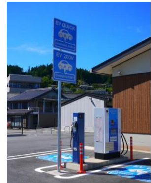
【充電設備の設置例】
