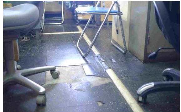
【執務室の床上配線】
