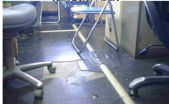
【執務室の床上配線】
