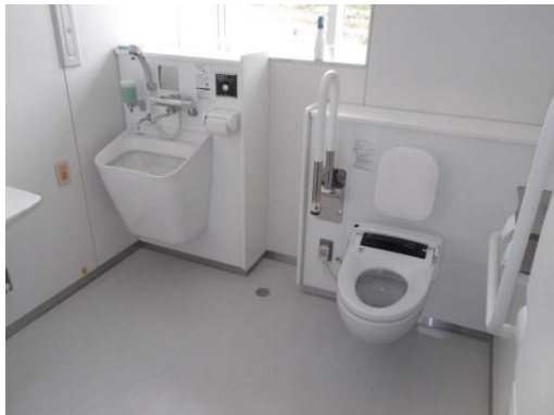
【オストメイト対応多目的トイレ】
