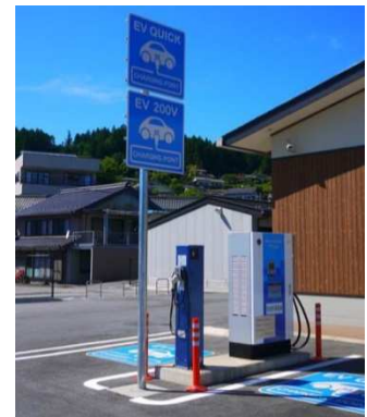
【充電設備の設置例 (設楽町庁舎)】
